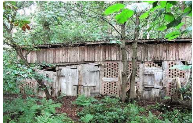
Ungenutzt und marode - der Torfschuppen vor dem Abbau.
