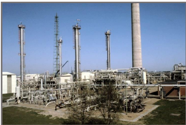
bis 1989: Erdgasreinigungsanlage der Wintershall
